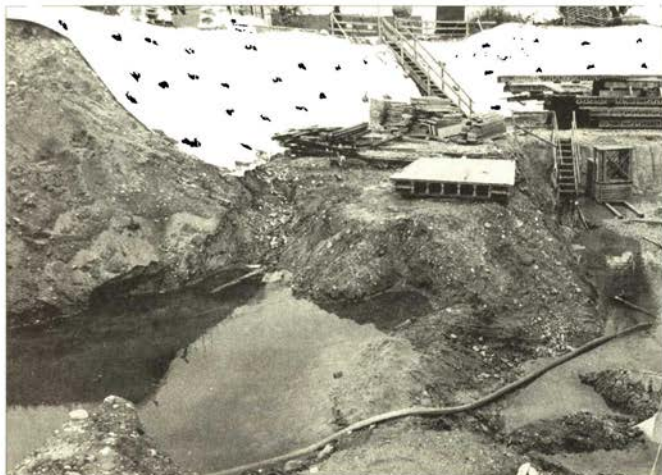
Abb. 11: Wassereintritt in die Baugrube der Straßenbrücke Weilbach/Bad Weilbach
